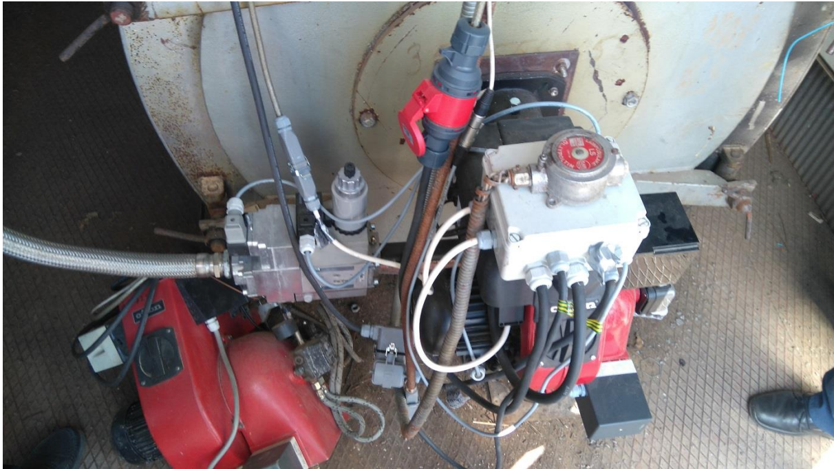
Kuva 3. Kaasukäyttöiseksi muutettu öljypoltin.
